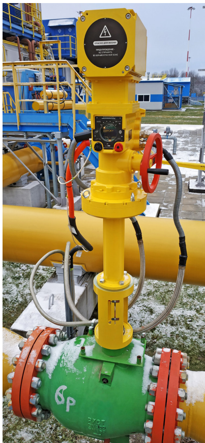
Рис. 2. Электропривод «РэмТЭК» на антипомпажном клапане серии РУСТ в составе агрегатной технологической обвязки на объекте компрессорной станции «Новгород»
