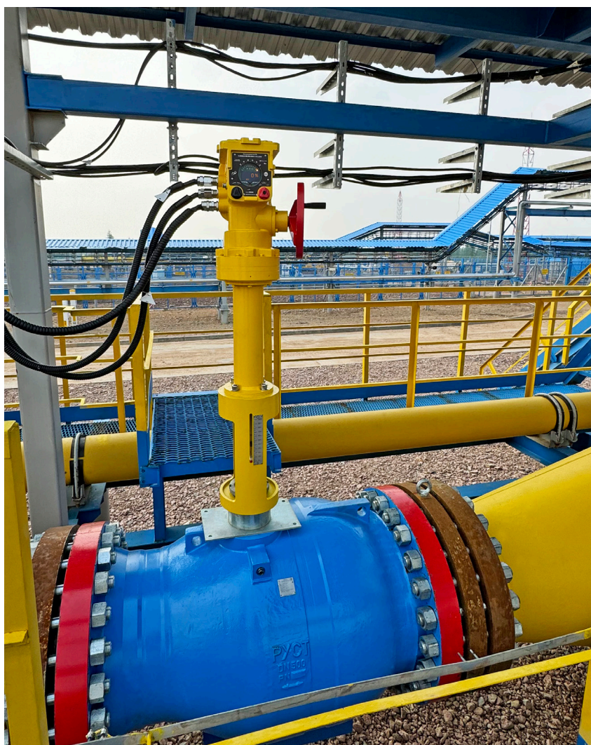
Рис. 4. Электропривод «РэмТЭК.Л.65000.9» на регулирующем клапане серии РУСТ в составе технологической обвязки на объекте компрессорной станции № 4 «Нимнырская»
